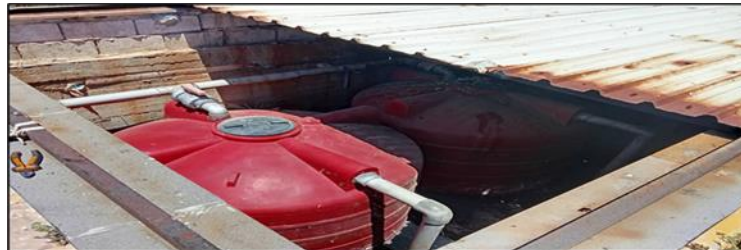
الشكل رقم (٧): وحدة معالجة المنصرفات السائلة في مشفى النور التخصصي (تصوير الباحث)
