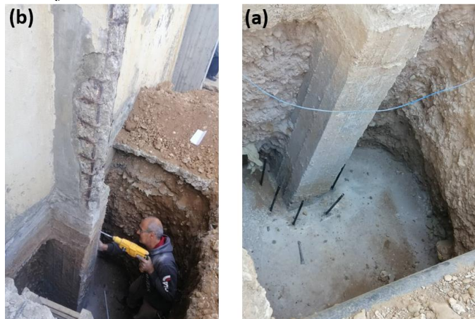
الشكل (١١): (a) زرع تشاريك فولاذية في الاساسات باستخدام الإيوكسي. (b) أعمال تثقيب الأعمدة القديمة لزرع تشاريك فولاذية.
