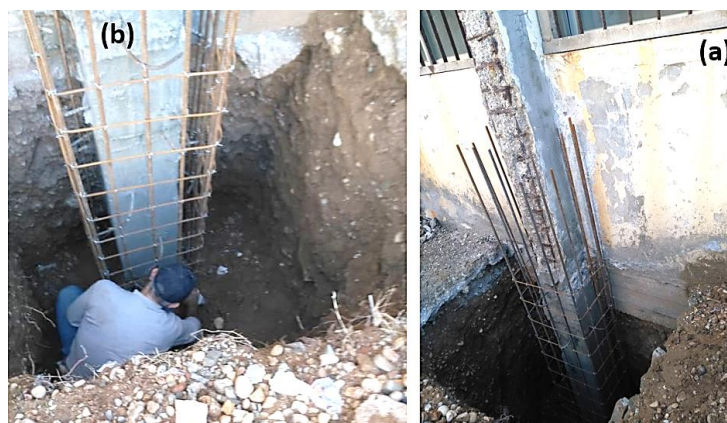
الشكل (١٢): (a) هيكل التسليح للقمصان البيتونية الجديدة . (b) تثبيت هيكل التسليح مع التشاريك المزروعة في الاساسات ومع التشاريك المزروعة مع الأعمدة القديمة، ويلاحظ عدم تضرر الأجزاء المطمورة من الأعمدة كونها كانت محمية من العوامل الجوية.
